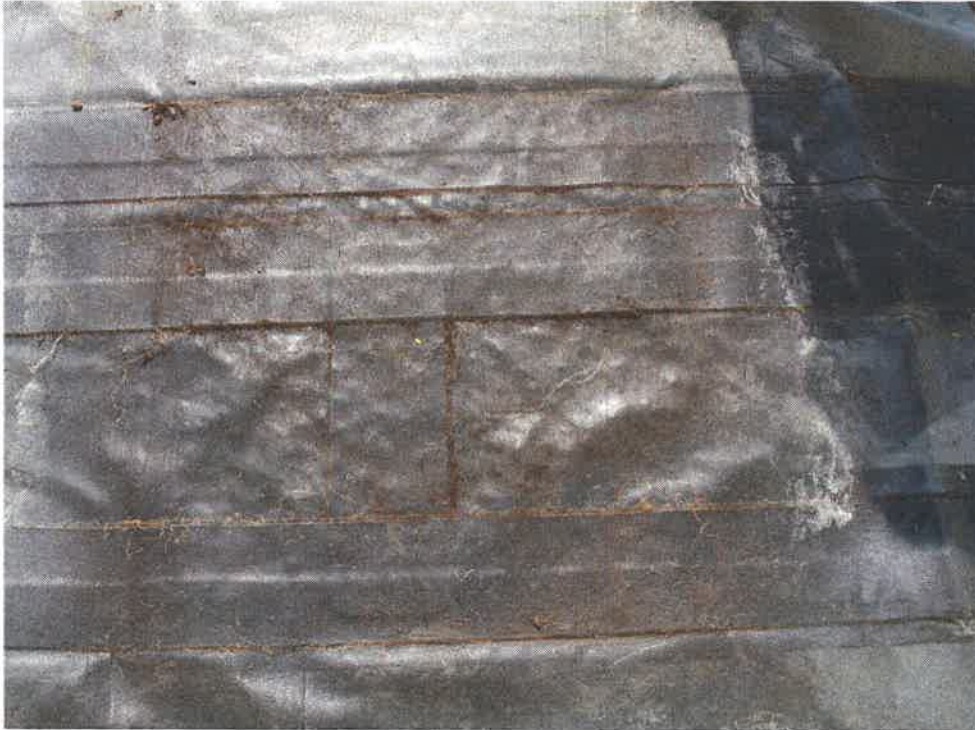
Abb. 1: Abdichtungsoberseite ohne Durchwurzlungen
